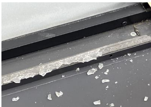
集熱ガラスの破損事例
