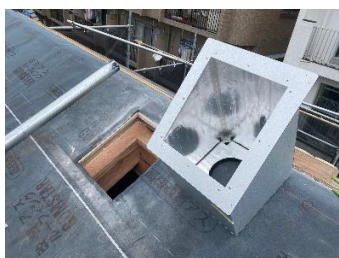
ダクト接続ボックス
