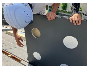
集熱パネルのダクト接続口
