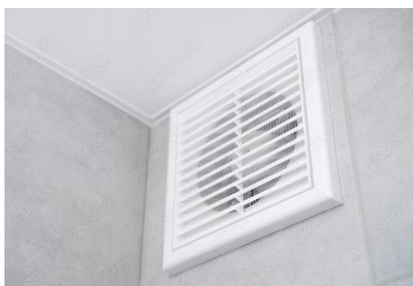
洗面所のパイプファン
