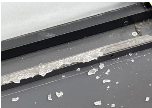
集熱ガラスの破損事例
