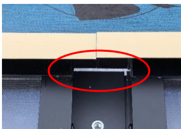
隙間が生じる
