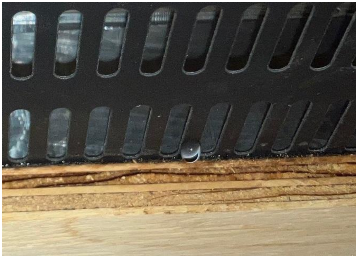
集熱パネル吸気口から漏れ出た雨水
